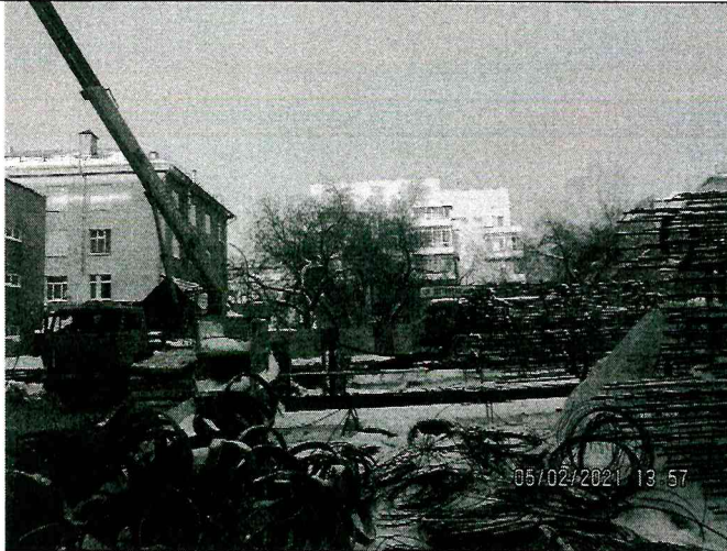
Нарушения, указанное в пункте 1 акта проверки
