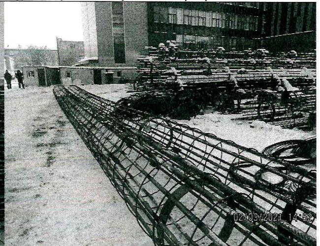
Нарушение, указанное в пункте 1 акта проверки
