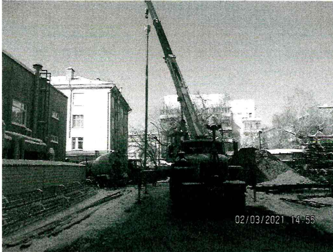
Нарушение, указанное в пункте 1 акта проверки
